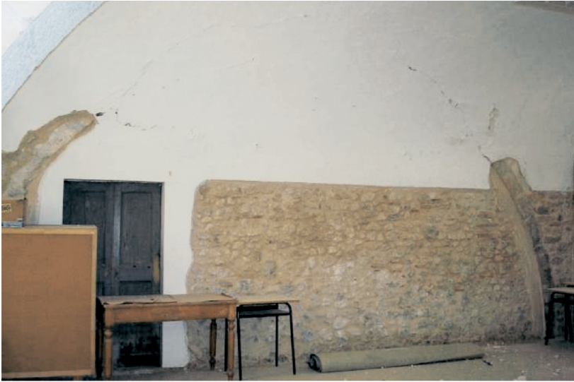
Figura 13. Muratura in blocchi di pietra non squadri con inclusioni di elementi in laterizio (tipo 3)
